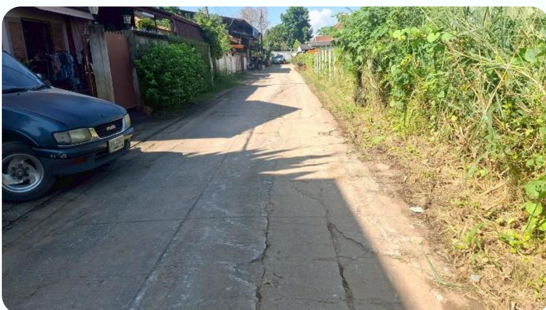
โครงการปรับปรุงถนนแอสฟัลต์ติกคอนกรีต รหัสสายทาง ชม.ถ.91-070 สายทางสันป่าเลียง ซอย 2 หมู่ที่ 4 บ้านสันป่าเลียง ตำบลหนองหอย
