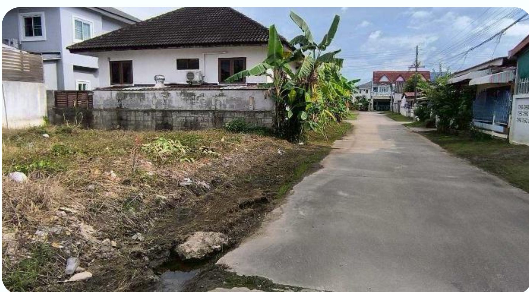
โครงการก่อสร้างรางระบายน้ำคอนกรีตเสริมเหล็กรูปตัวยูแบบมีฝาปิด ซอย 8 เชื่อมซอย 12 หมู่ที่ 7 บ้านชัยพฤกษ์ ตำบลหนองหอย
